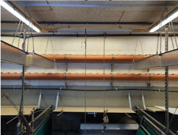
Abbildung 6: Schweinestall: zu erkennen ist das Wandrohrsystem (mittig hinten) und Abhängungen aus Edelstahl für Balkonkästen links und rechts
